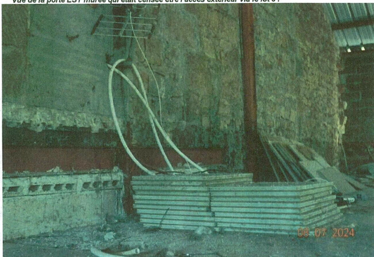
Vue de la porte EST murée qui était censée être l'accès extérieur via le lot 3 .
